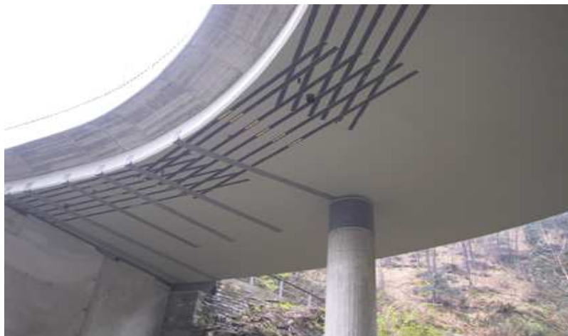
Rinforzo piattabanda con lamelle in fibre di carbonio e lamelle in acciaio. L'armatura di frettaggio della pila è rinforzata con tessuto in fibre di carbonio.
